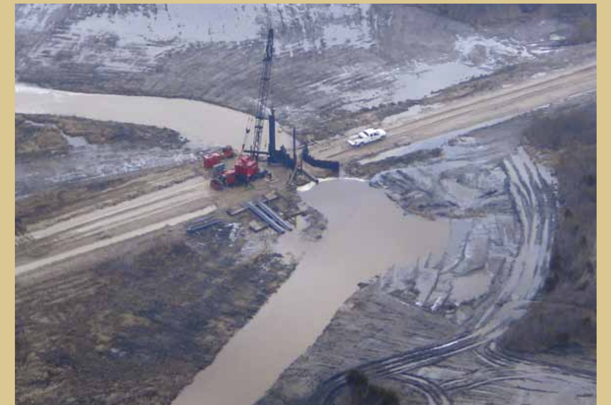
Un des dispositifs de régulation de l'eau, ou déversoirs, en cours d'installation.
